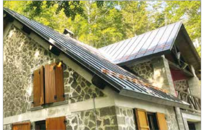
In alto, il rifugio Marchetti al lago Santo; sotto, il tetto del rifugio Santi alla Vetricia con i nuovi tubi para neve
